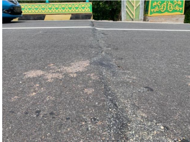
Gambar 3.3 Dokumentasi Penurunan Timbunan pada Oprit Jembatan
