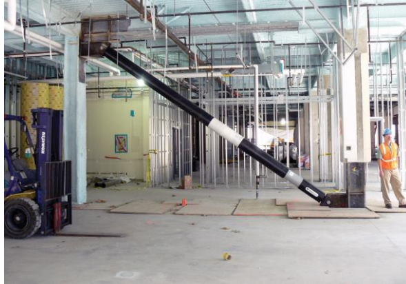
Gambar 2. 4 Pemasangan Fluid Viscous Damper pada Bangunan Gedung Sumber: (Berquist et al. 2022)
