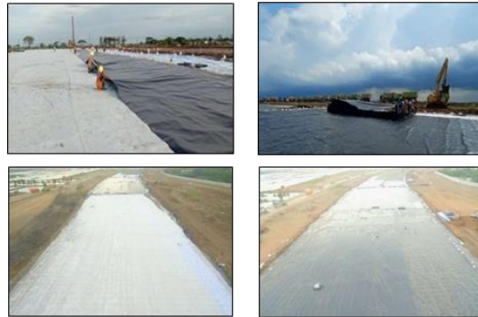
Gambar 2.34 Lapisan Proteksi ( Geotekstil Non Woven ) dan Lapisan Kedap ( Geomembrane ) (Sumber: PT Geostructure Dynamics, 2023)
