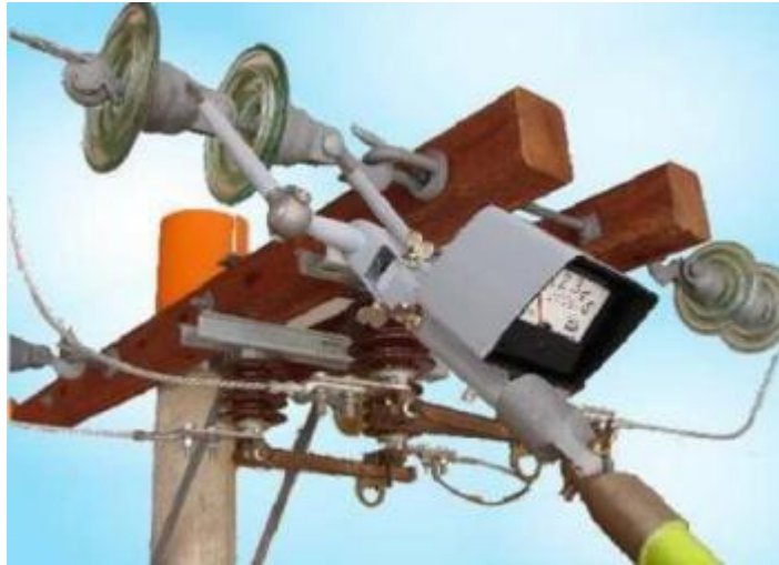
Gambar 2.12 Isolator pada Jaringan Tegangan Menengah (Sumber : (Prasetyo and Hidayah 2013))
