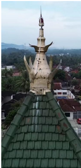
Gambar. 3.12 Mustaka Masjid Agung Manonjaya. Sumber: Drone DKM Masjid Agung Manonjaya
