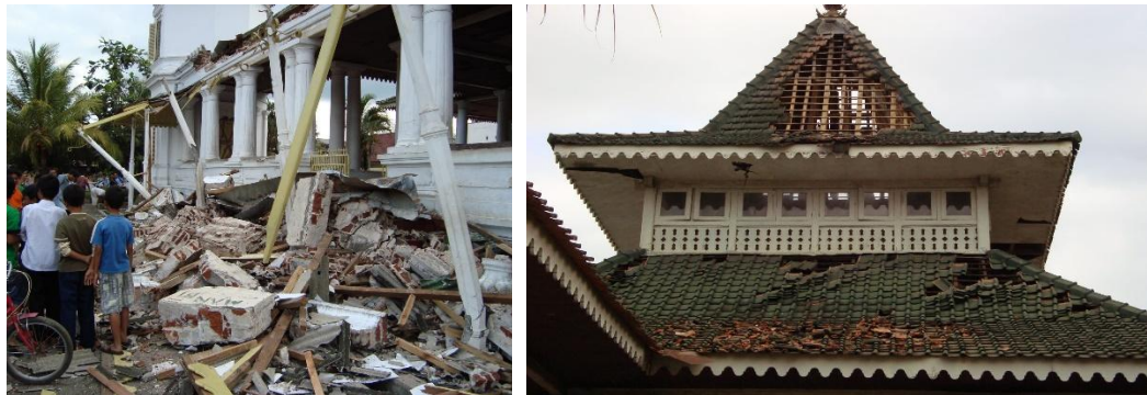
Gambar. 3.17 Kerusakan Masjid Agung Manonjaya akibat gempa bumi 2009.
