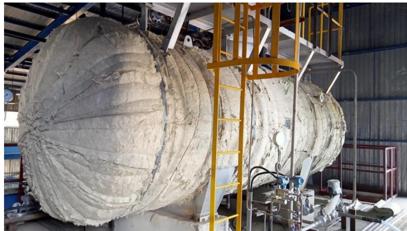
Gambar 2.2 Boiler Pembangkit Listrik
