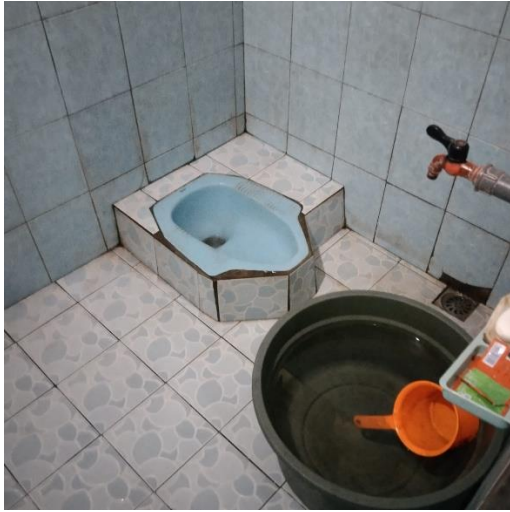
Kondisi jamban plengsengan terlihat seperti jamban pada umumnya tetapi pengaliran limbah langsung pada kolam/sungai
