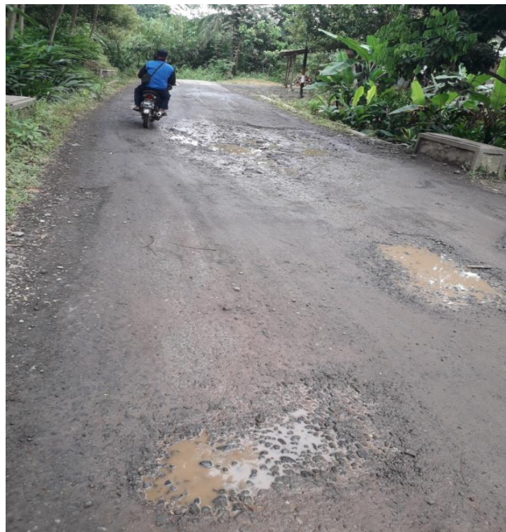
Gambar 3 1 Kondisi Jalan Raya Darawati-Bojonggambir
