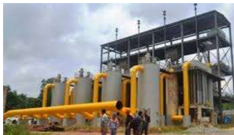
Gambar 2. 9 Pembangkit Listrik Tenaga Biomassa (PLTBm)
