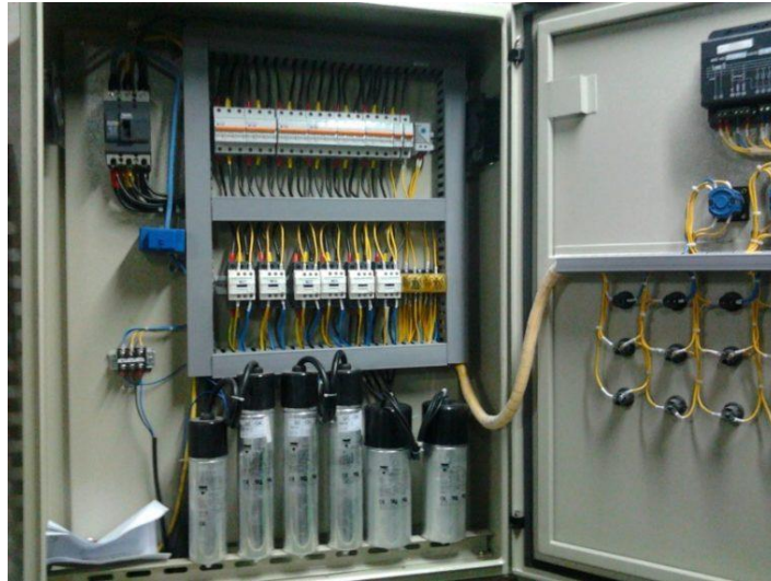
Gambar 2. 15 Kapasitor Bank di Lapangan
