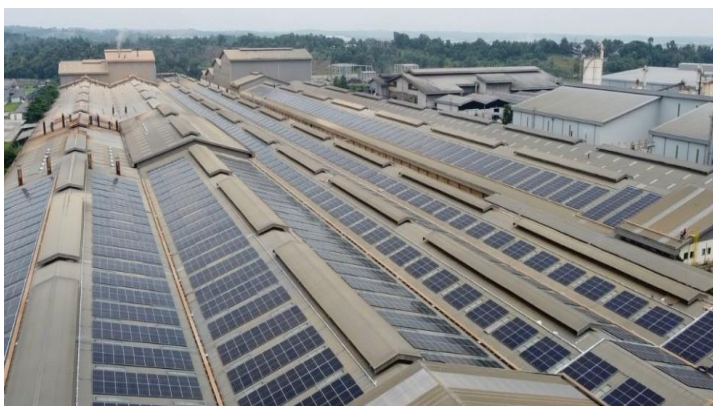
Gambar 2. 8 Pembangkit listrik tenaga surya rooftop ( SUN Energy )
