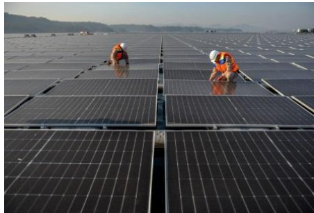
Gambar 2.2 Pembangkit Listrik Tenaga Surya
