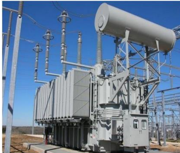
Gambar 2.6 Transformator Tenaga (Sumber : Diktat Sistem Tenaga Listrik Universitas Sumatera Utara)
