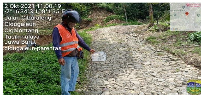
Gambar 3.1 Kondisi Jalan Raya Cidugaleun-Parentas Sumber : PUPR Kab. Tasikmalaya
