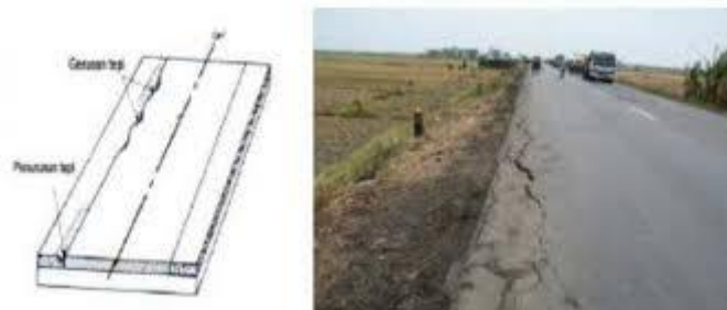
Gambar 2 7 Retak Samping Jalan ( Edge Cracking )
