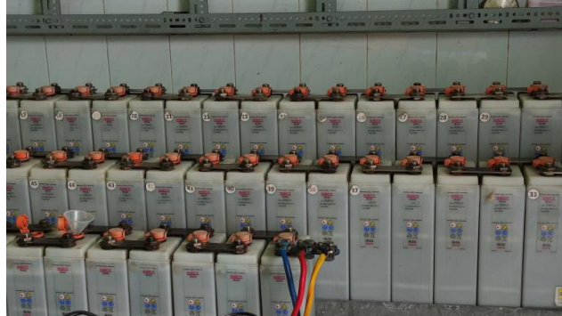
Gambar 3. 2 Baterai 211 Ah Gardu Induk Tasikmalaya 150KV
