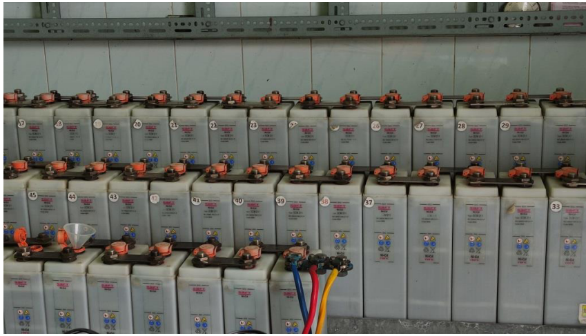
Gambar 2. 13 Baterai 110 VDC Bank 1 Pada Gardu Induk 150 KV Tasikmalaya.
