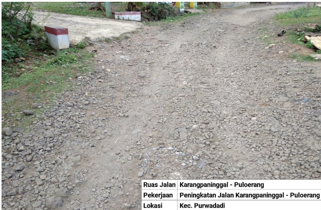
Gambar 3. 1 Rusaknya Lapisan Atas Jalan Karangpaningal-Puloerang
