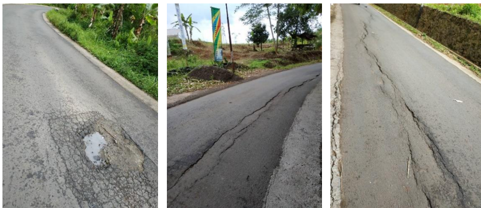
Gambar 1.1 kerusakan jalan Setiawargi
