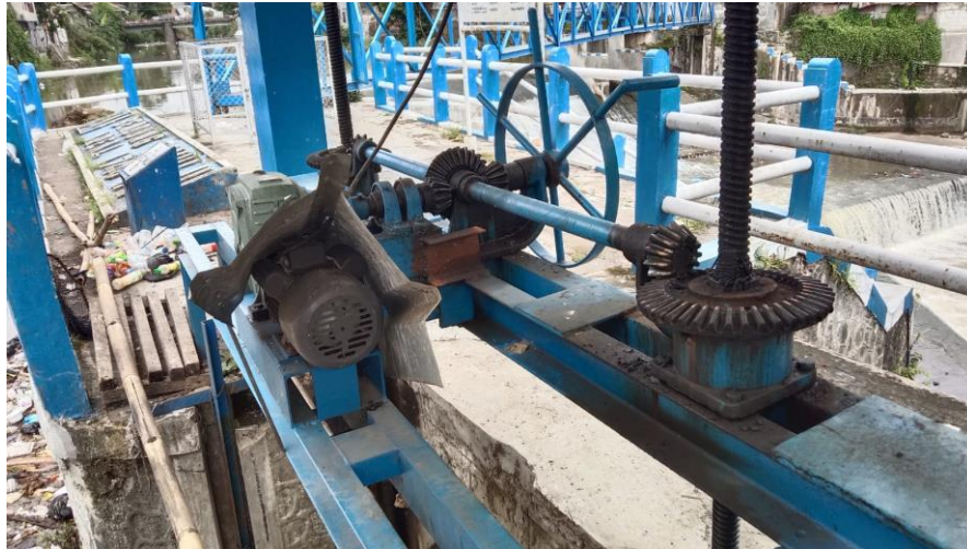
Gambar 3. 4 Motor induksi 1 fasa pada sebuah bendungan
