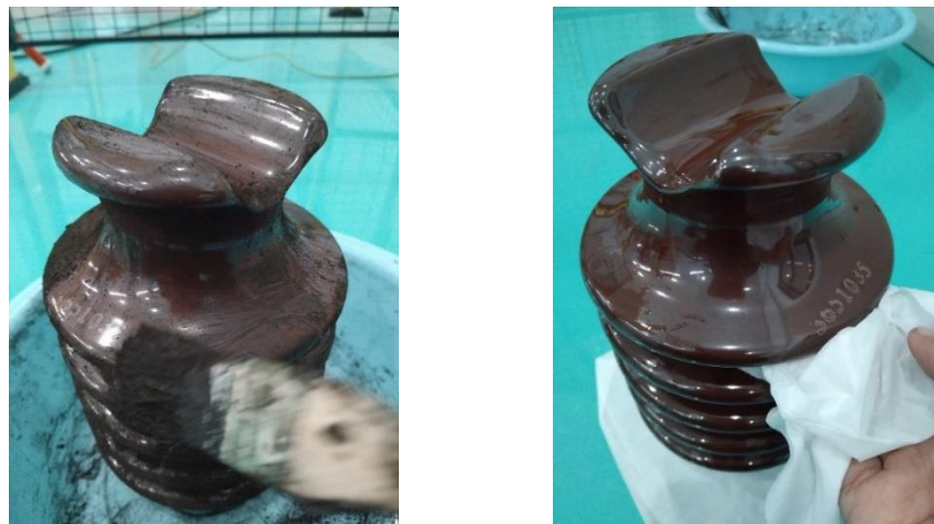
Gambar 3.9 Proses pembersihan isolator
