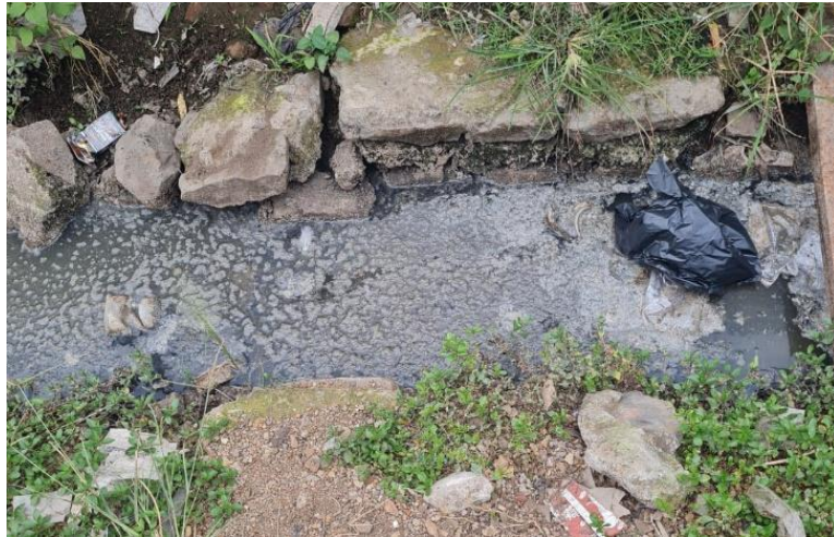
Kondisi Saluran Pembuangan Air Limbah di Pasar Pancasila
