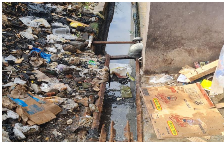
Kondisi Saluran Pembuangan Air Limbah yang dipenuhi sampah di Pasar Pancasila
