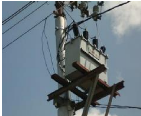
Gambar 2. 11 Jenis pasangan luar pada gardu cantol
