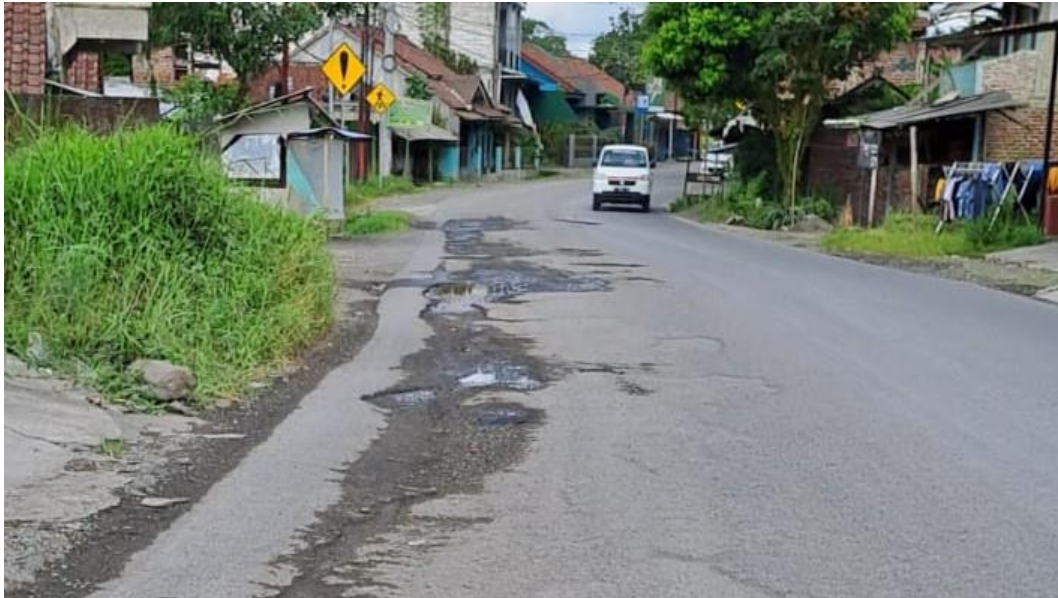
Gambar 3. 3 Kondisi Perkerasan Ruas Jalan Cisinga (Gambar ke-2)
