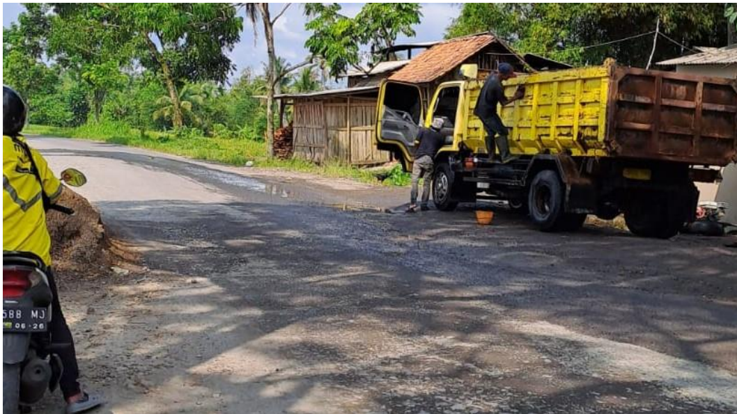
Gambar 3. 2 Kondisi Perkerasan Ruas Jalan Cisinga (Gambar ke-1)
