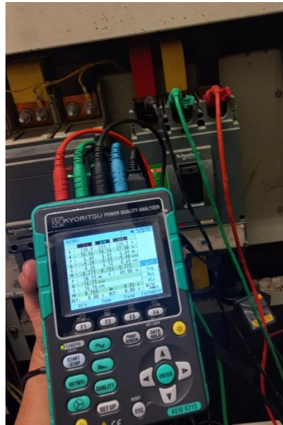
Gambar 3. 3 Pengukuran menggunakan Power Analyzer
