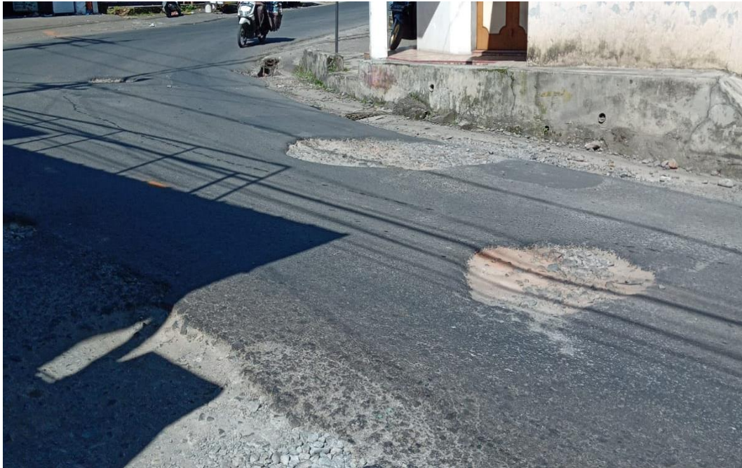
Gambar 3.2 Kerusakan pada Jalan Bojong Jengkol STA 0+000
