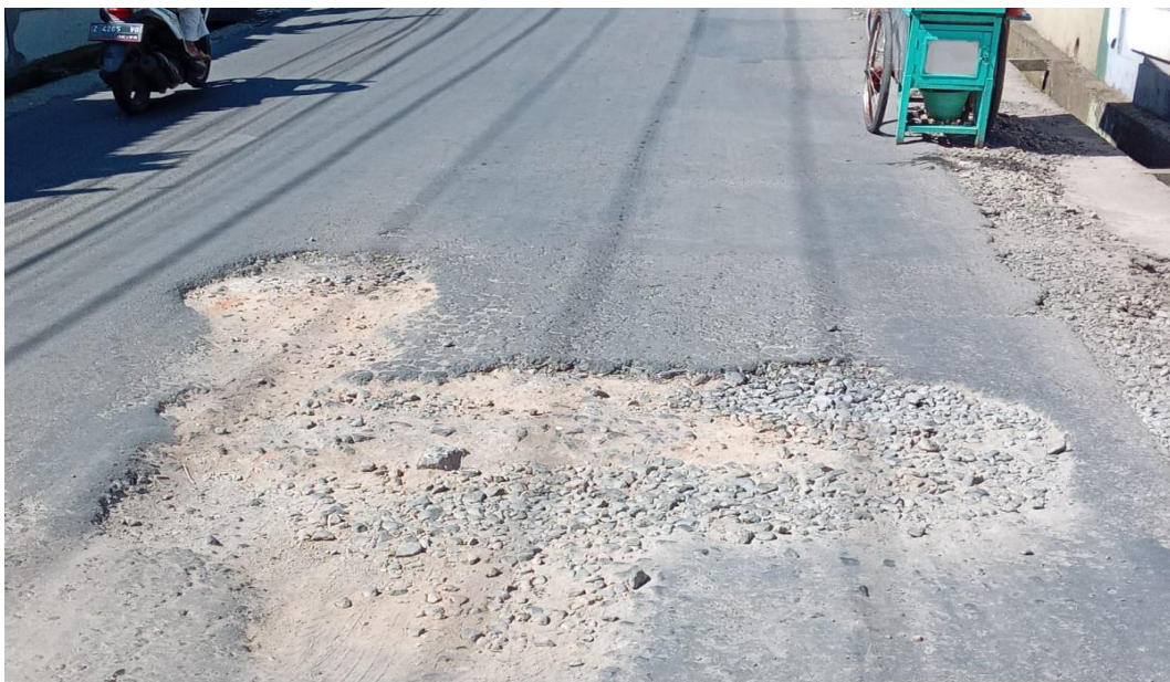
Gambar 3.3 Kerusakan pada jalan Bojong Jengkol STA 0+150
