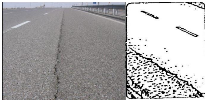
Gambar 2.11 Retak Sambungan Bahu Dan Perkerasan
