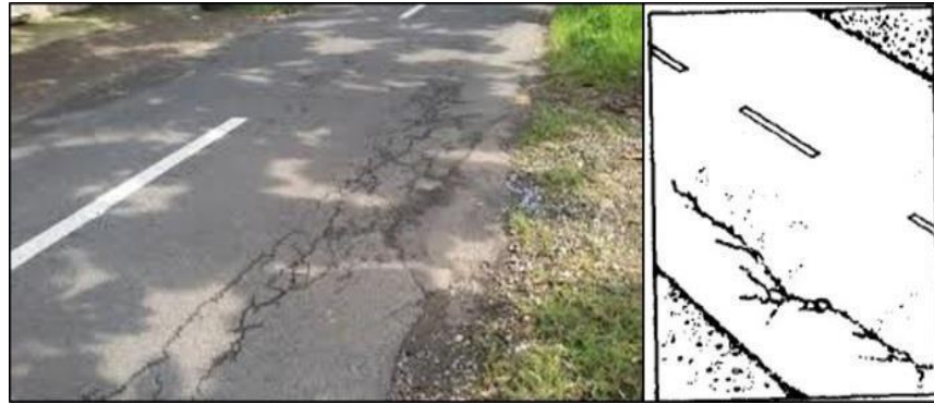
Gambar 2.10 Retak Pinggir ( Edge Crack )
