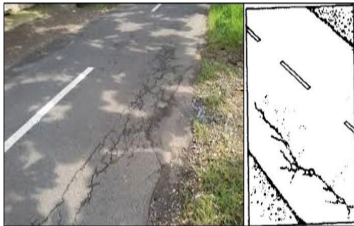
Gambar 2.20 Retak Pinggir ( Edge Cracking )
