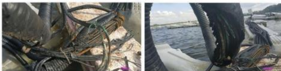
Gambar 2. 14 Kabel dan conduit yang terendam air (ESDM, 2021)
